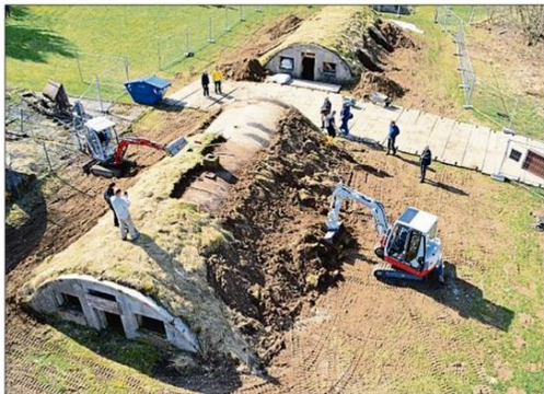
Auf dem Gelände des ehemaligen KZ-Außenlagers Kaufering VII sind Tonröhrenunterkünfte erhalten. Diese werden gerade archäologisch aufgearbeitet und saniert.
