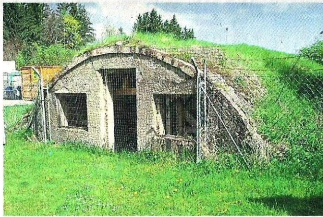
Sanierungsfall: eine ehemalige Häftlingsbaracke, die erhalten bleiben soll.
