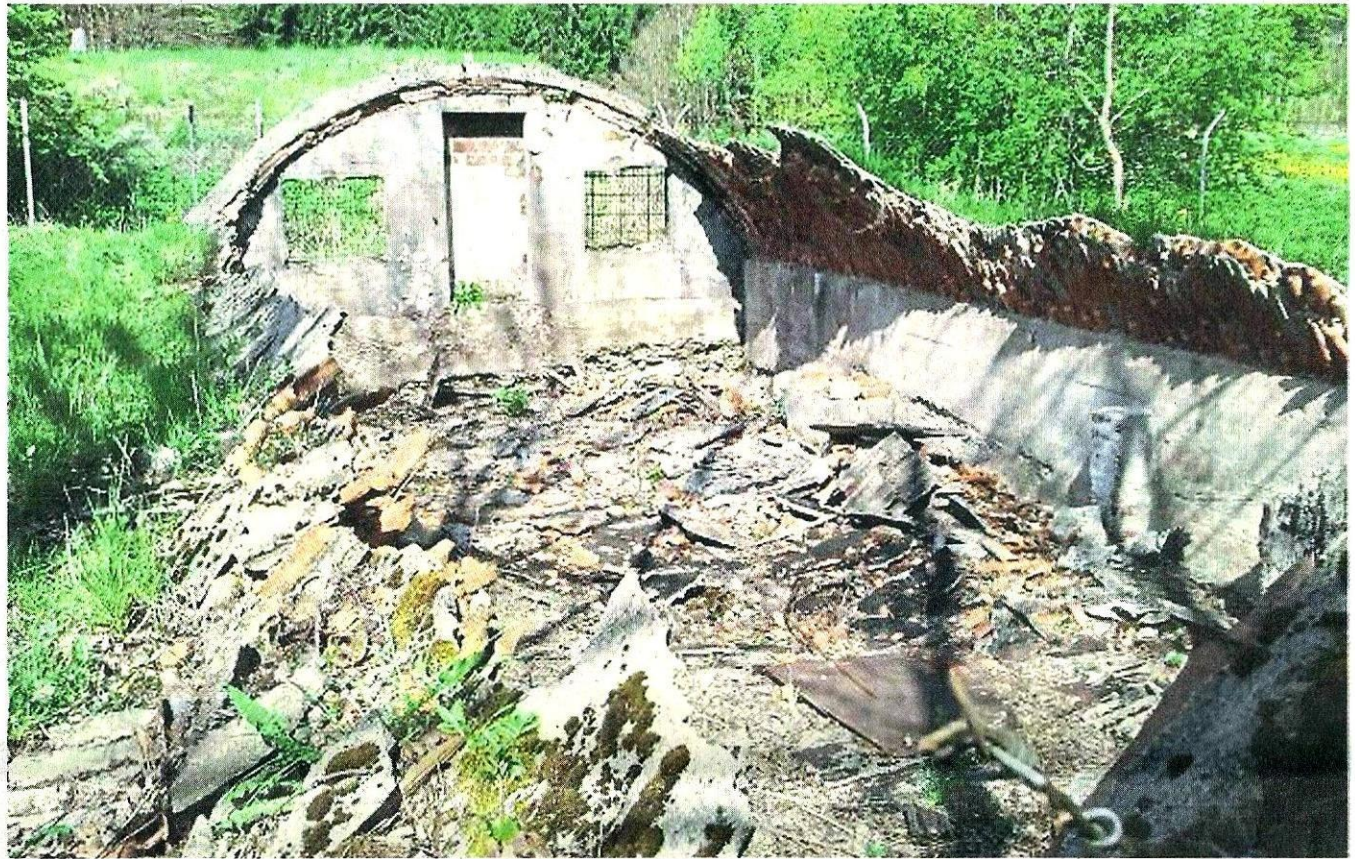
Nicht mehr zu retten: Eine ehemalige Häftlingsbaracke im KZ Kaufering VII. Am Boden zu sehen sind auch die Reste von Tonflaschen, die ineinander gesteckt wurden – so entstand die Dachwölbung. FOTOS (2): DW
